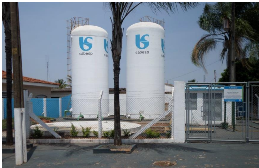
Imagem 9.3: Vista geral do Poço 03 e do Reservatório 02 do setor São Sebastião.
