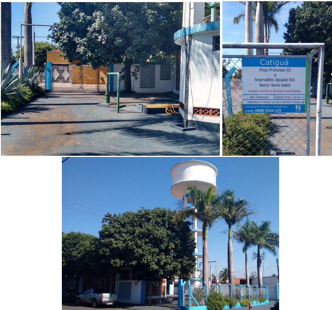
Imagem 9.6: Vista geral do Poço 02, placa de identificação e Reservatório 01 do setor Santa Isabel.
