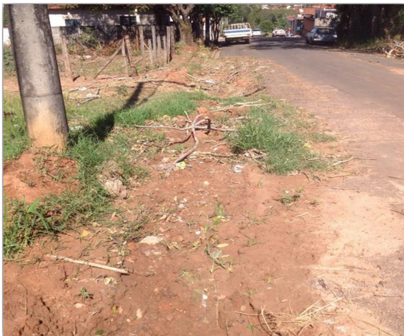
Imagem 11.7: Rua sem leito de escoamento com falta de guia e sarjeta.
