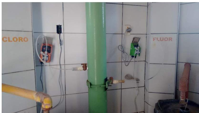
Imagem 9.11: Dosador automático de cloro e flúor do Reservatório 01.
