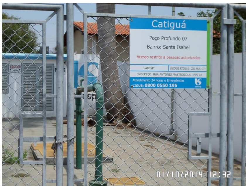
Imagem 9.5: Vista do Poço 07 do setor São Sebastião.
