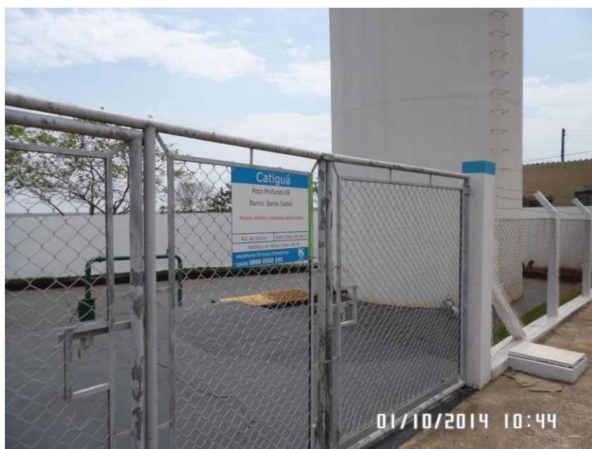
Imagem 9.8: Vista geral do Poço 08 e do Reservatório 05 do setor Santa Isabel.
