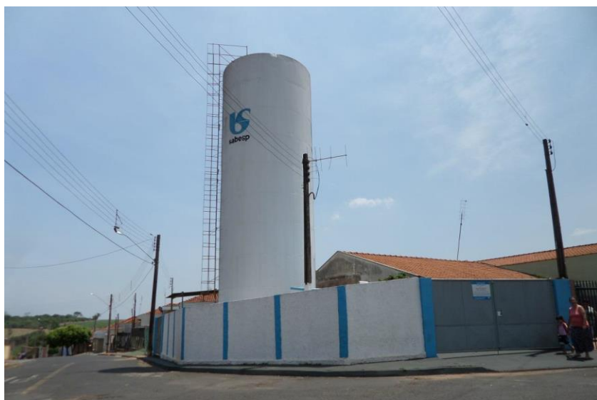
Imagem 9.4: Vista geral do Poço 06 e Reservatório 04 do setor São Sebastião.
