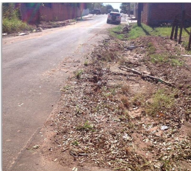
Imagem 11.8: Rua sem leito de escoamento com falta de guia e sarjeta.
