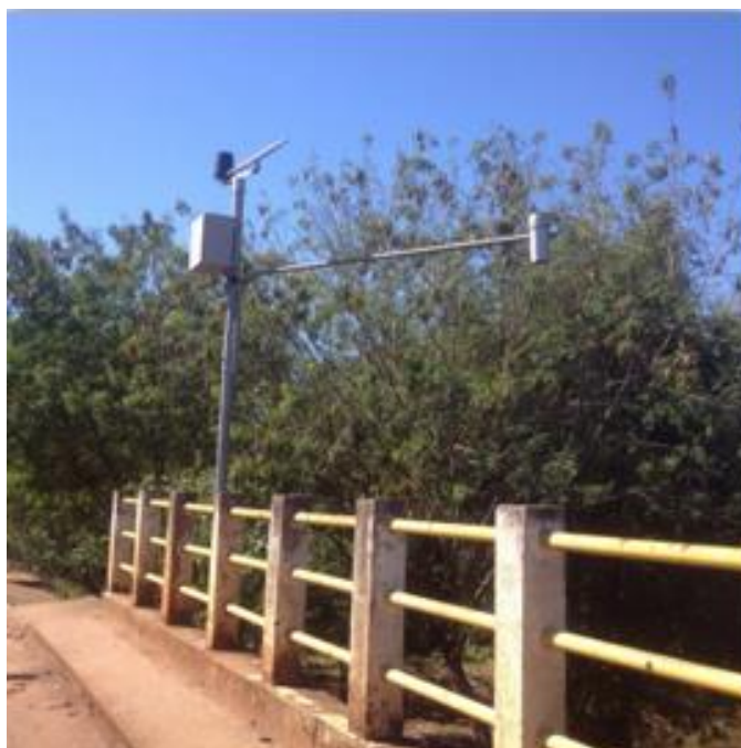
Imagem 11.13: Rede telemétrica instalada às margens do rio São Domingos.
