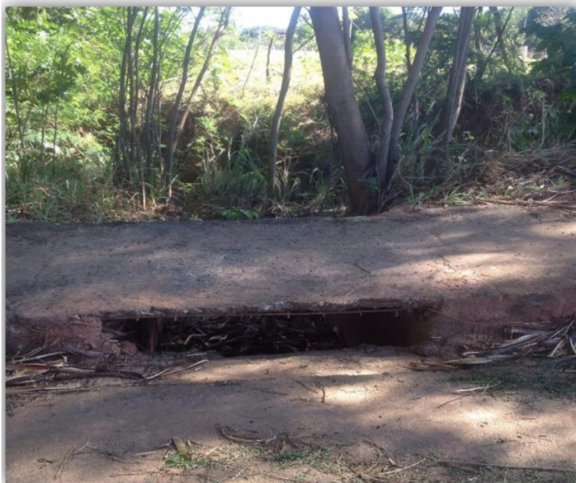
Imagem 11.6: Boca de lobo obstruída.
