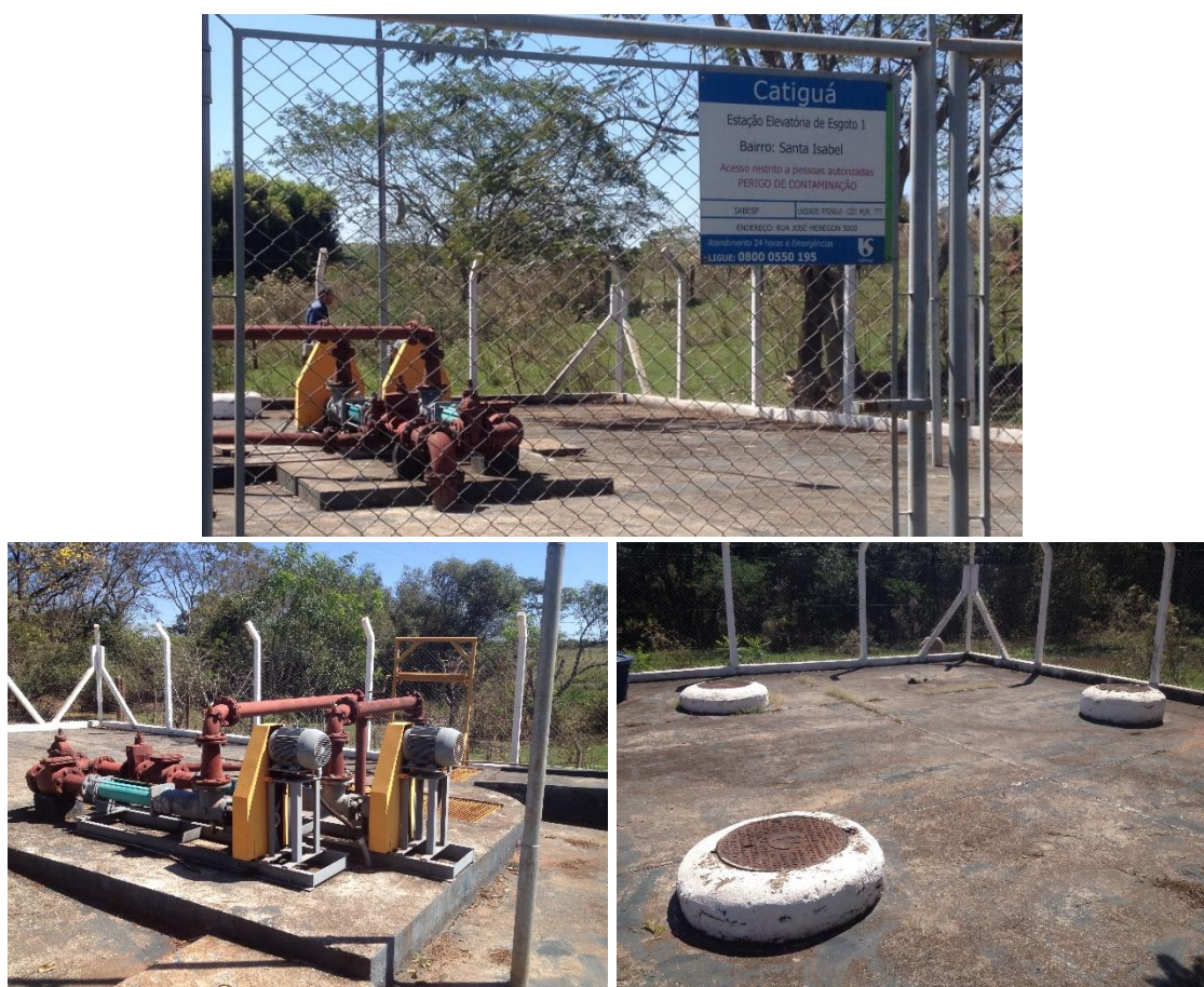
Imagem 10.1: Estação Elevatória de Esgoto – EEE-01.
