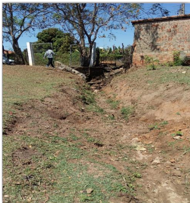
Imagem 11.4: Erosão existente na avenida José Vaz Pereira Neto.
