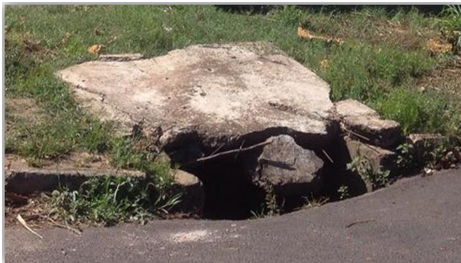
Imagem 11.1: Boca de lobo com tampa rompida provavelmente por tráfego de veículo pesado.
