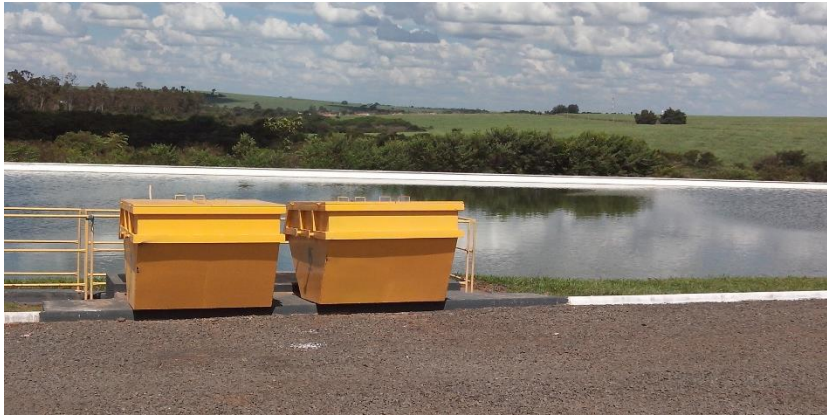
Imagem 10.5: Caçambas de armazenamento de resíduos de gradeamento.
