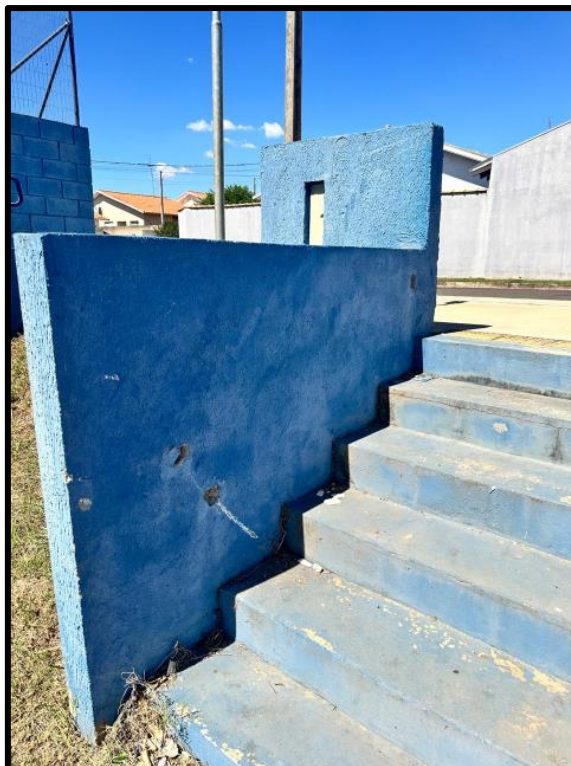
Ausência de corrimão.
