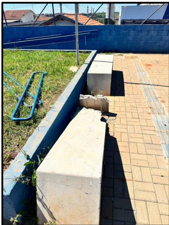
Banco quebrado e corrimões soltos.
