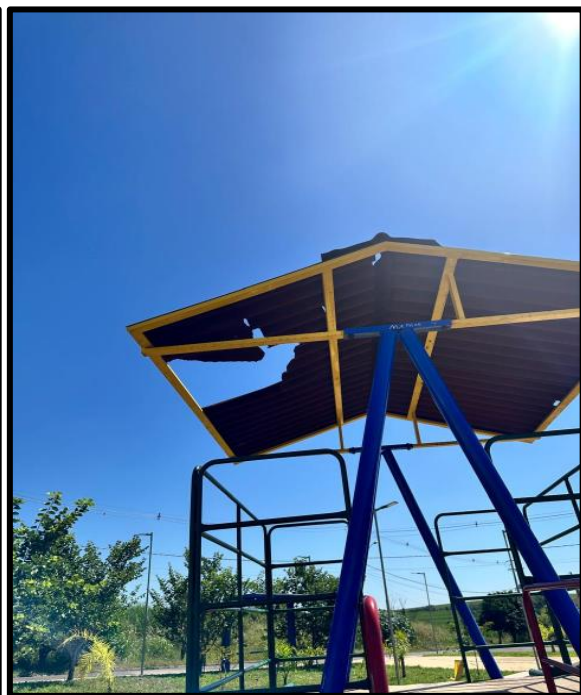
Brinquedo com a cobertura danificada.
