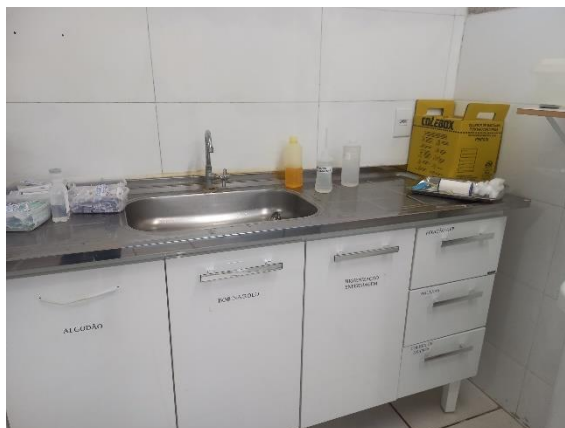
- Sala de curativo: armário com puxador quebrado, amarrado com tecido.
