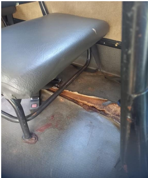
- Ônibus CDV-2304: assoalho danificado.
